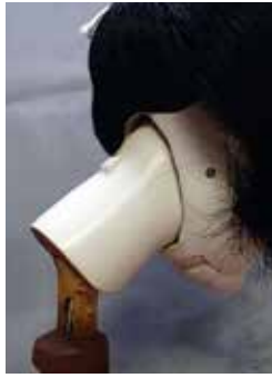
写真17 No.49 ノド木に木片が挿入されている。
