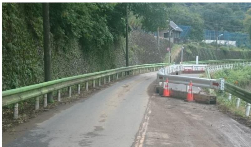
力石付近の崩落現場
