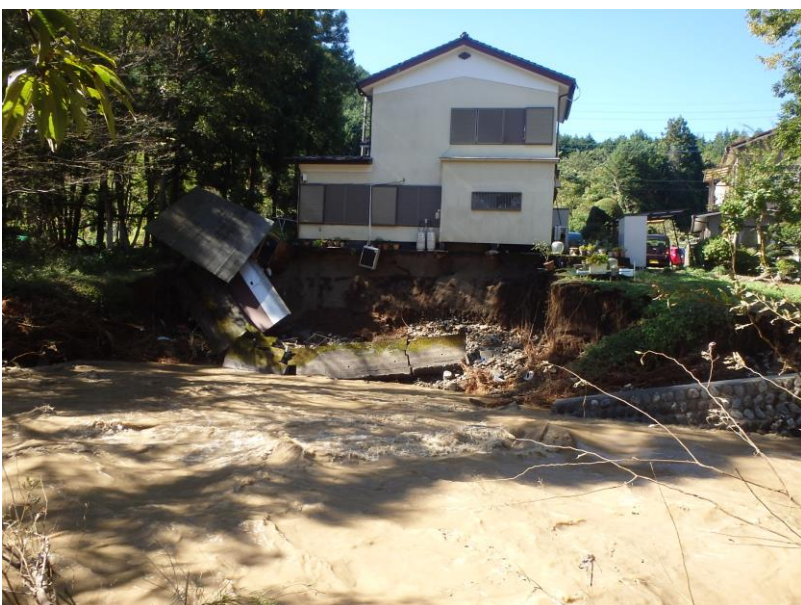
下恩方町の北浅川護岸洗堀による住宅 への被害
