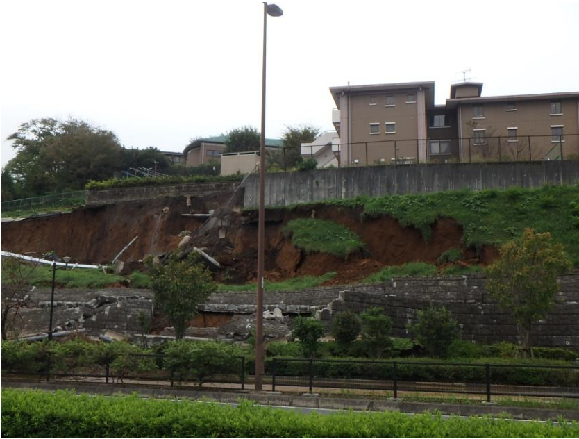
新滝山街道及び加住 111 号線 法面崩壊
