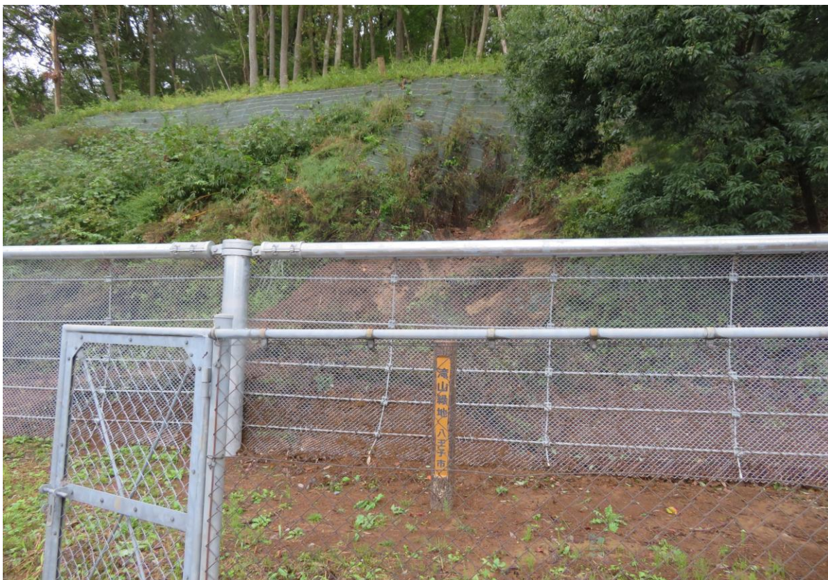
滝山緑地における土砂崩れの様子
