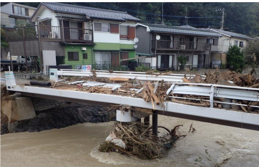
白山橋高欄損傷
