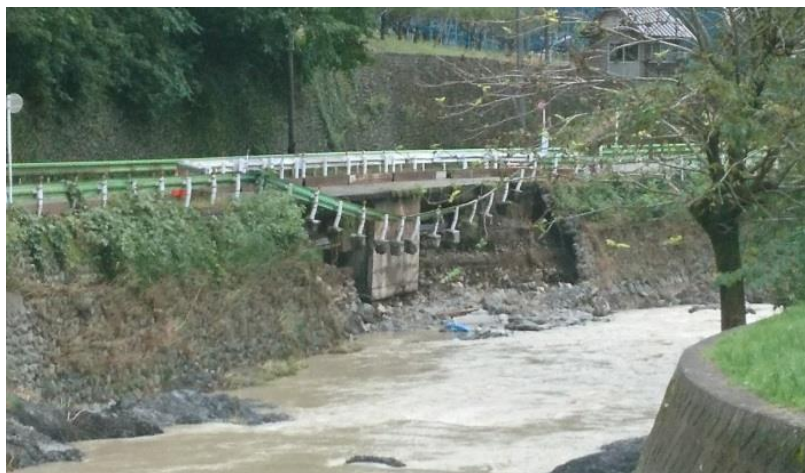
力石付近の崩落現場
