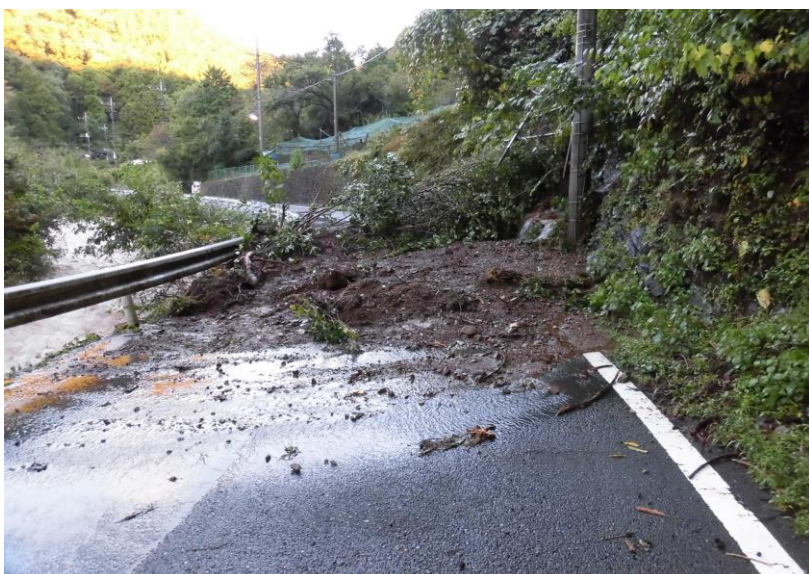
上恩方町土砂崩れ現場
