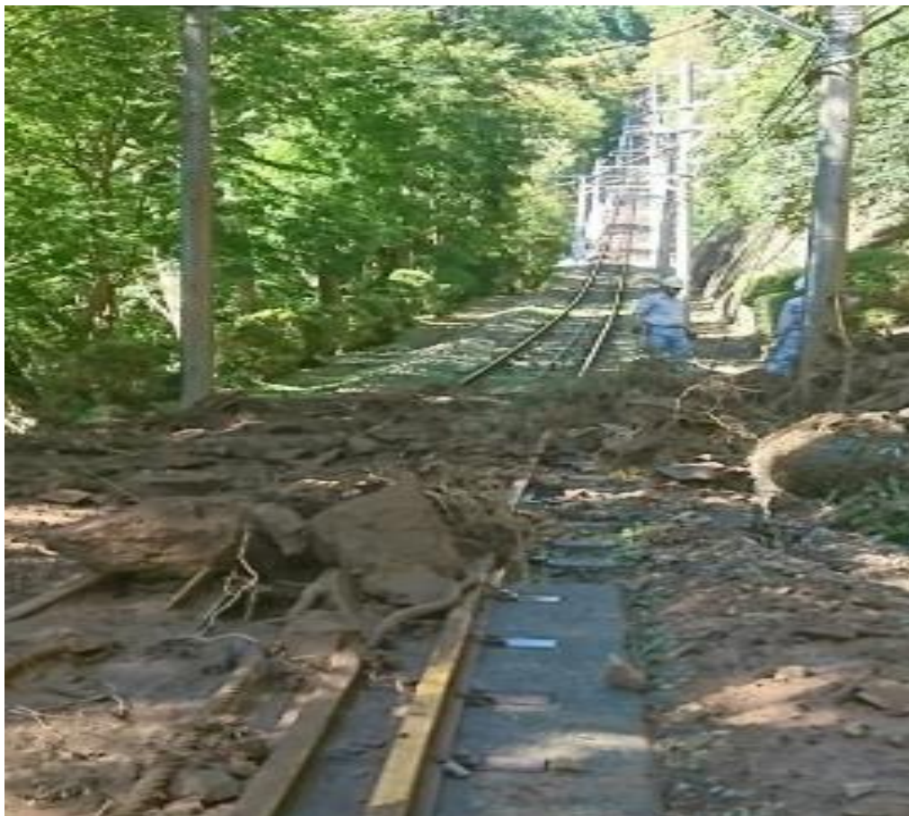
ケーブルカー沿線における土砂崩れの様子 （提供：高尾登山電鉄株式会社）
