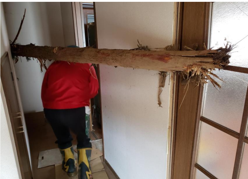
上恩方町の土砂災害による 住宅内の被害状況 (提供：上恩方町中郷地区自主防災会)
