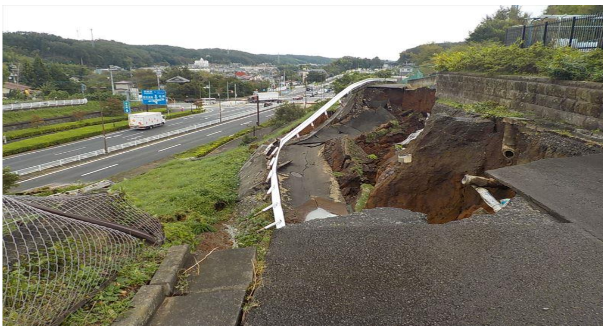
法面崩壊により下水道管が断裂（戸吹町）
