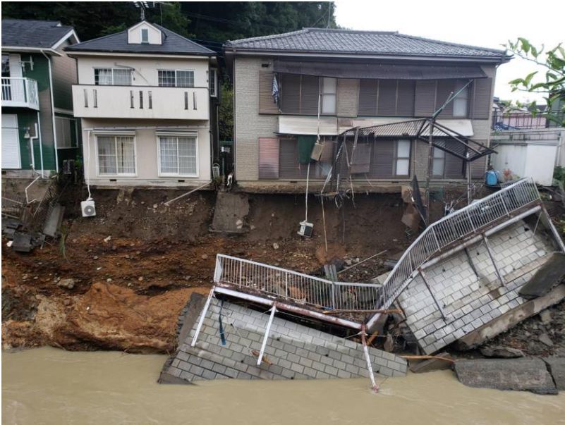
廿里南浅川護岸崩壊状況 (提供：高尾町上宿町会自主防災会)
