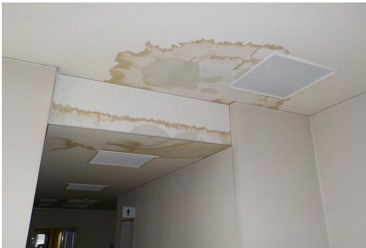
北野清掃工場における雨漏りの様子
