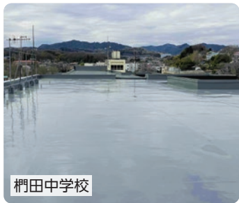
雨などが染み込まないように防水改修 工事で整備した学校の屋上
