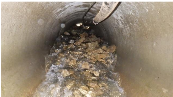
土砂による管路詰まり
