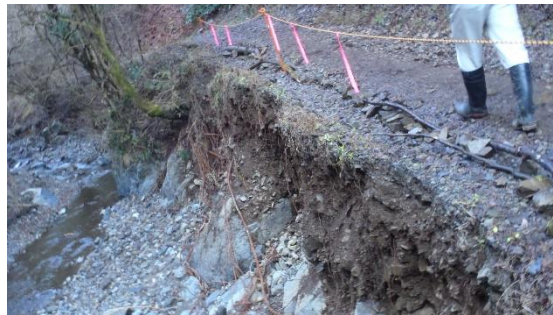
河岸侵食による護岸崩壊
