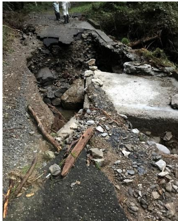
河岸侵食による道路崩壊
