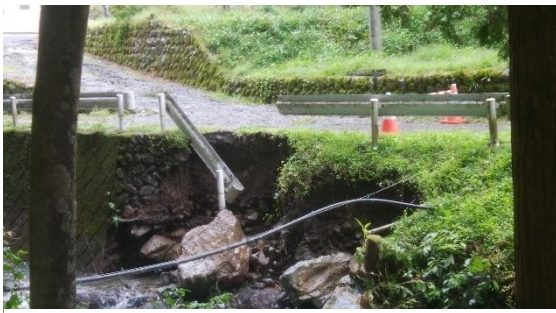
河岸侵食による護岸崩壊
