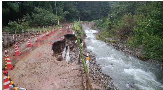
河岸侵食による道路崩壊
