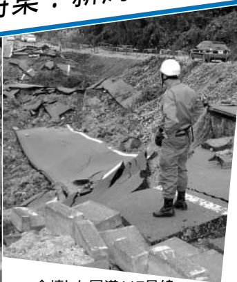
全壊した国道117号線
