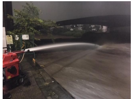
▲浸水した雨水の排水状況（東浅川町）
