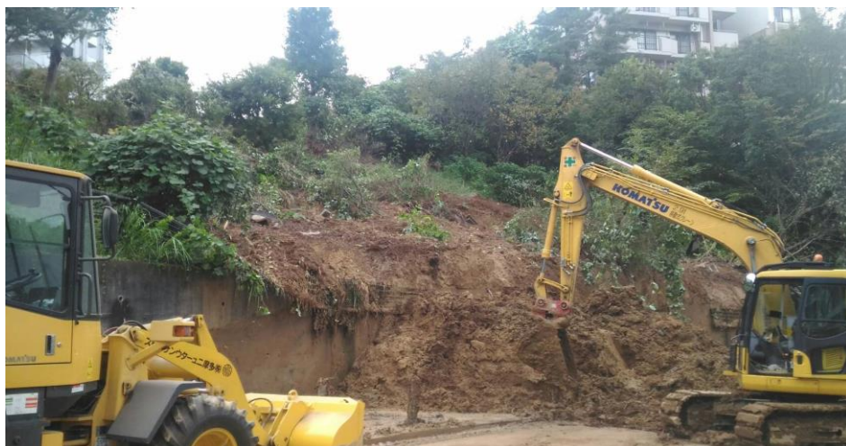
▲土砂崩れ現場（別所）
