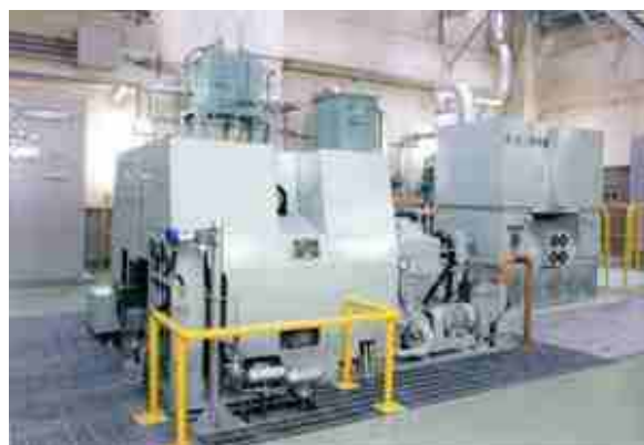
蒸気タービン発電機
