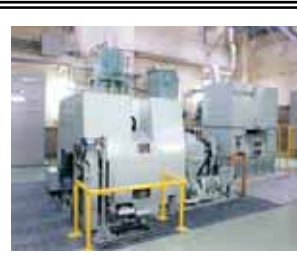
蒸気タービン発電機
