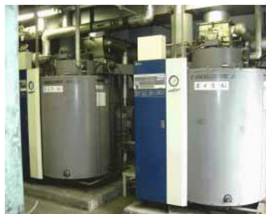
防爆用蒸気ボイラ
