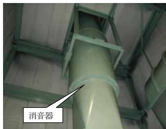
集塵設備用消音装置
