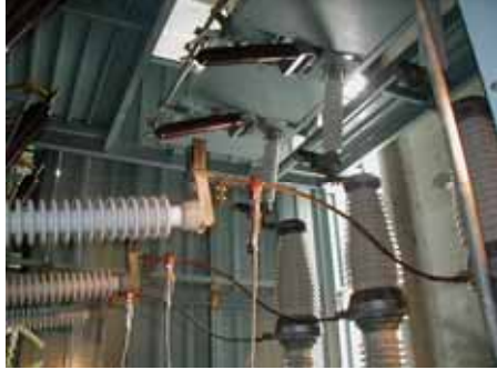
(66,000V 特別高圧受電設備)
