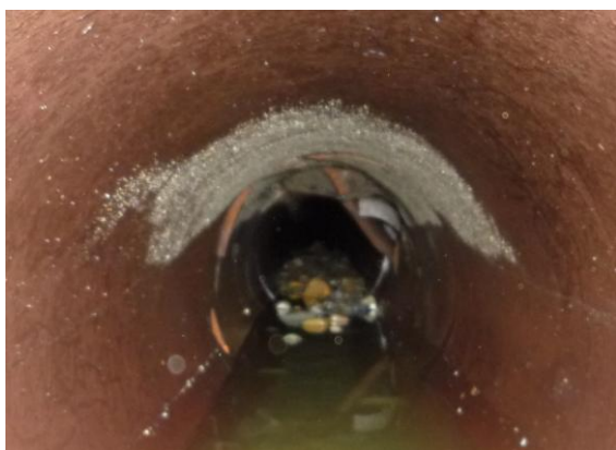
破損した下水道管
