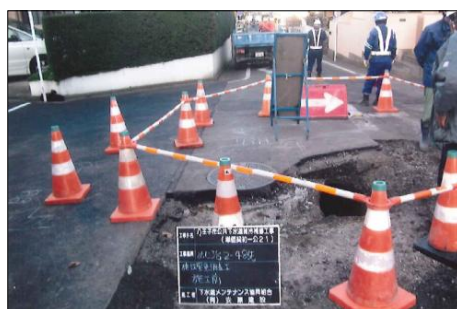
下水道管が原因の道路陥没（建設から30年以上経過すると陥没が多くなる傾向にある）
