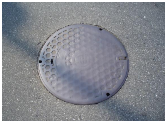
摩耗したマンホール蓋
