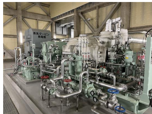
蒸気タービン発電機 最大出力 4,440kW
