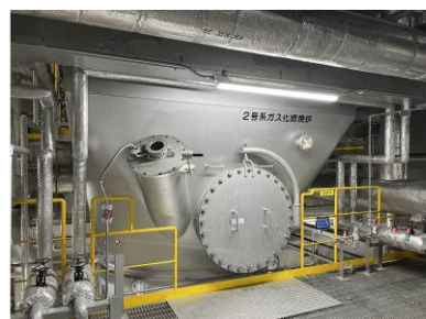
流動床炉式ガス化燃焼炉
