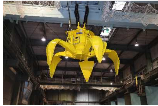
ごみクレーン
