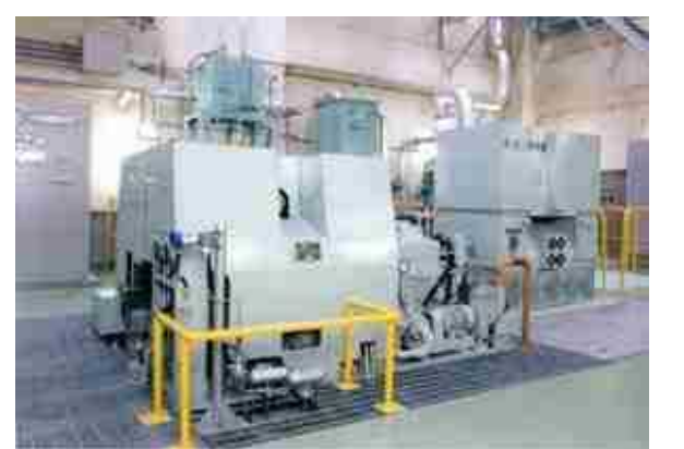
蒸気タービン発電機
