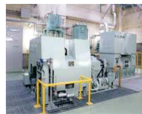
蒸気タービン発電機
