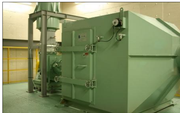
③活性炭吸着式脱臭装置
