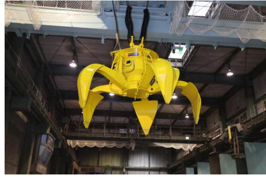
ごみクレーン
