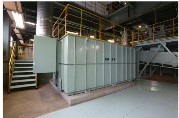
② 脱臭装置
