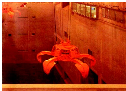
ごみクレーン
