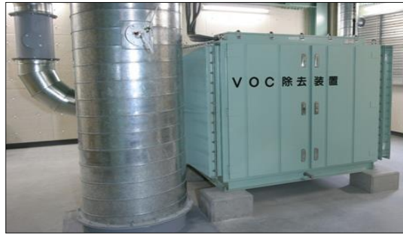
②VOC除去装置
