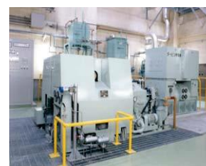
蒸気タービン発電機
