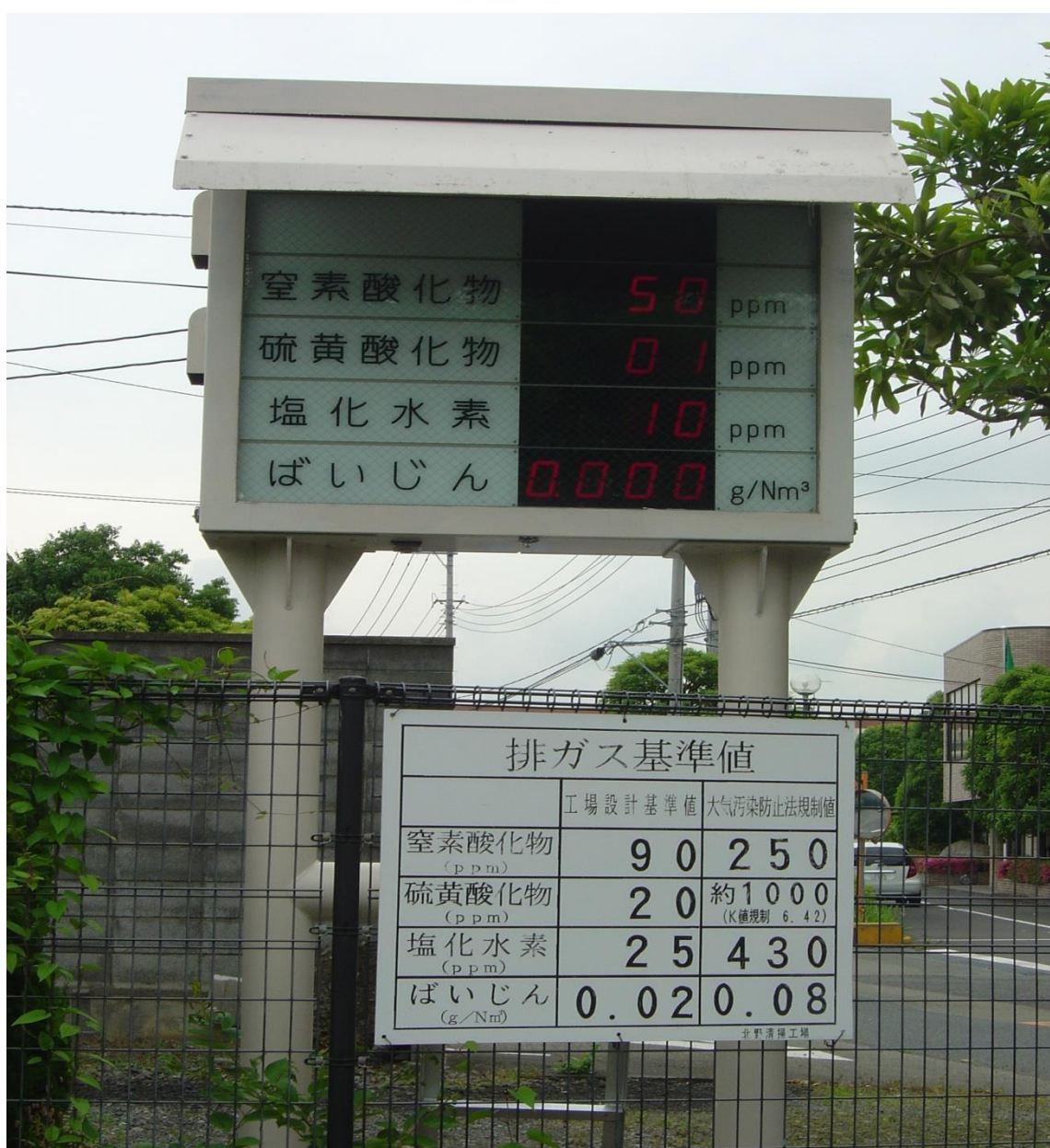
「排ガス状況表示盤」
