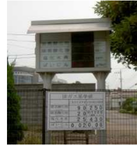
排ガス状況表示盤
